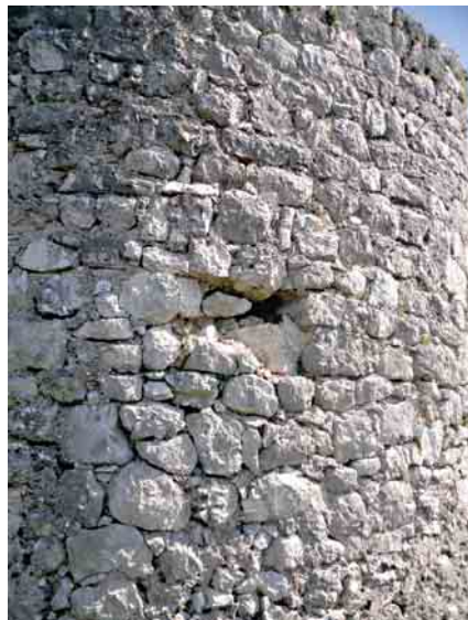
Oštećenje na kuli na Lesendru od topovskog duleta
