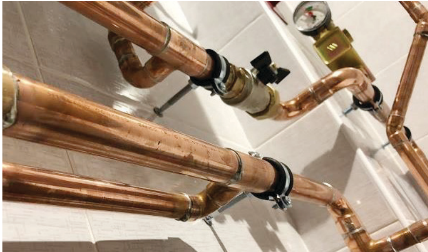
Instalirane vodovodne bakarne cijevi, foto: engineers.techinfus.com
