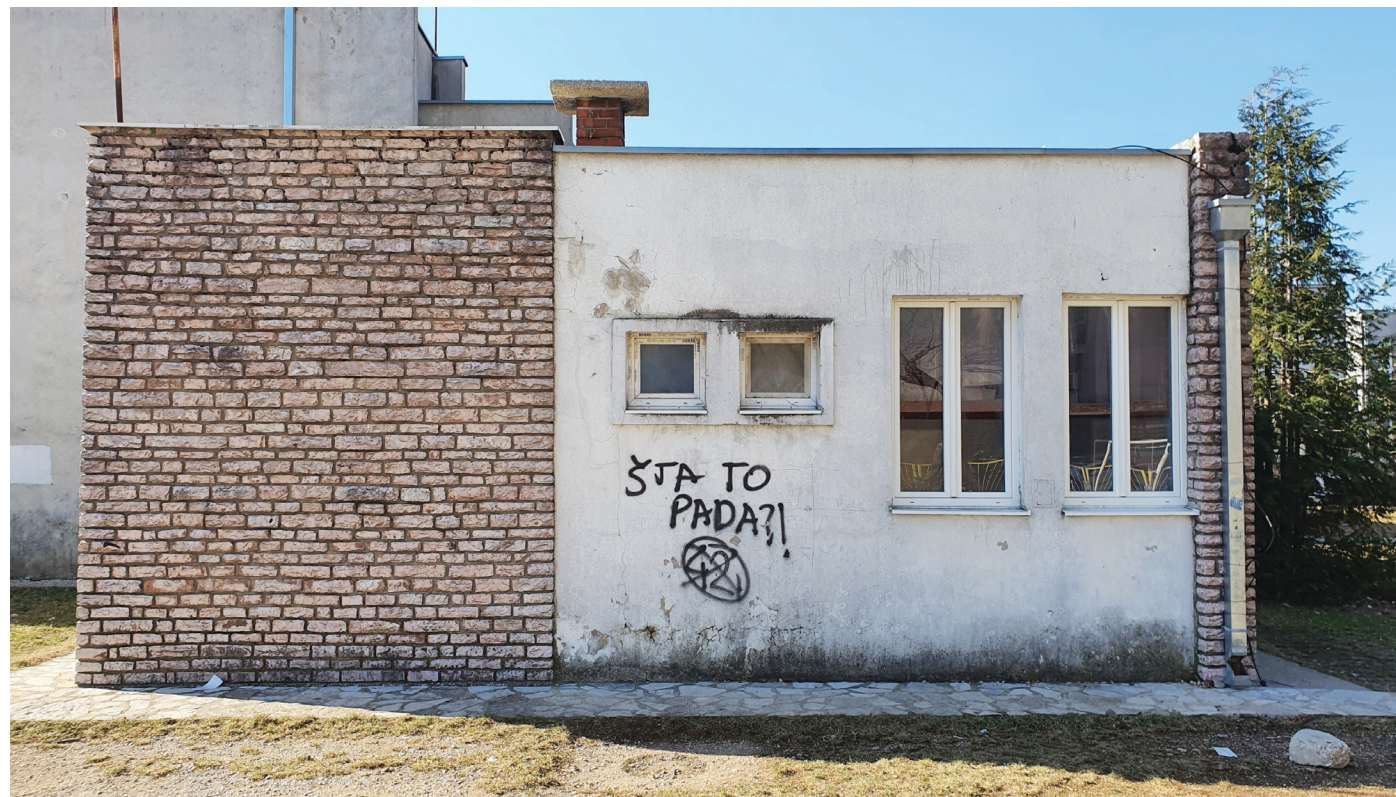
Djeca određenog uzrasta sklona su da oštećuju već oštećene površine i predmete, foto: N. Bulajić
