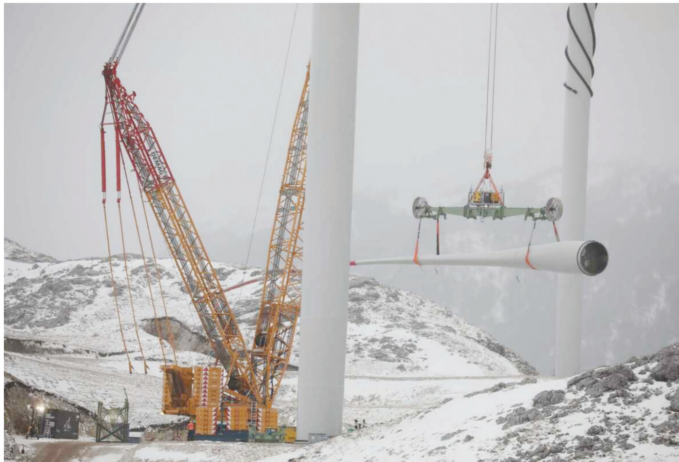
Vjetrogenerator je instaliran u okviru vjetroparka Gvozd, foto: EPCG
