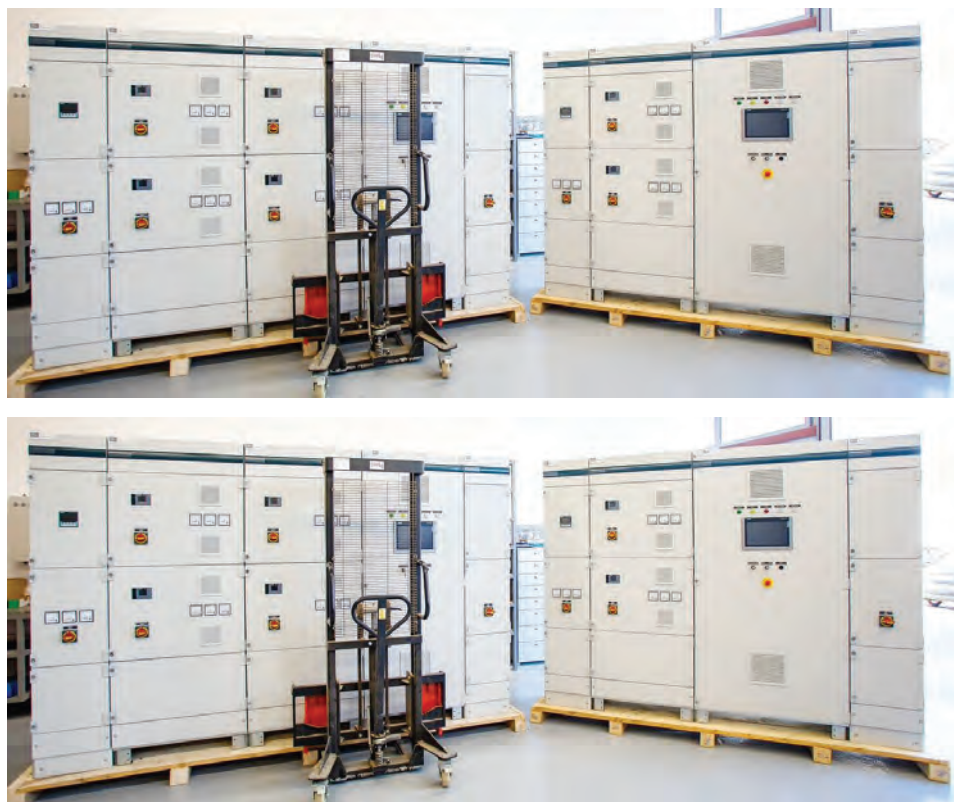
Slika 4. Upravljački ormari za branu u Dubajju
