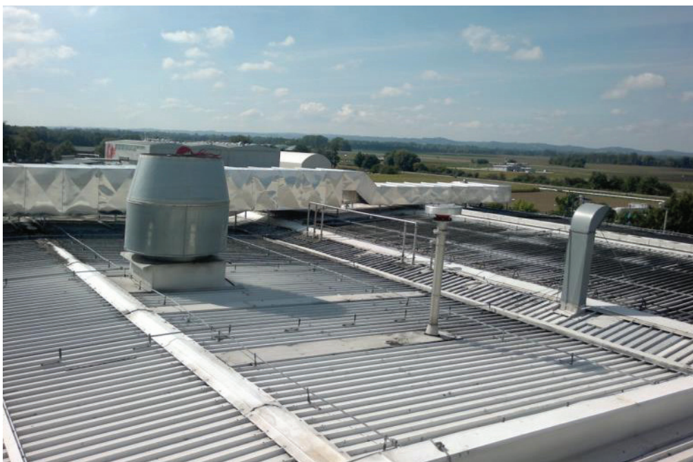
Slika 12: Nepravilno izvedena zaštita na objektu, gdje se nalaze odzračnici sa Ex zonama iznad objekta
