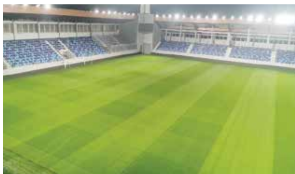
Slika 3. Instalacija osvetljenja modernog stadiona „TSC Arena“, Bačka Topola
