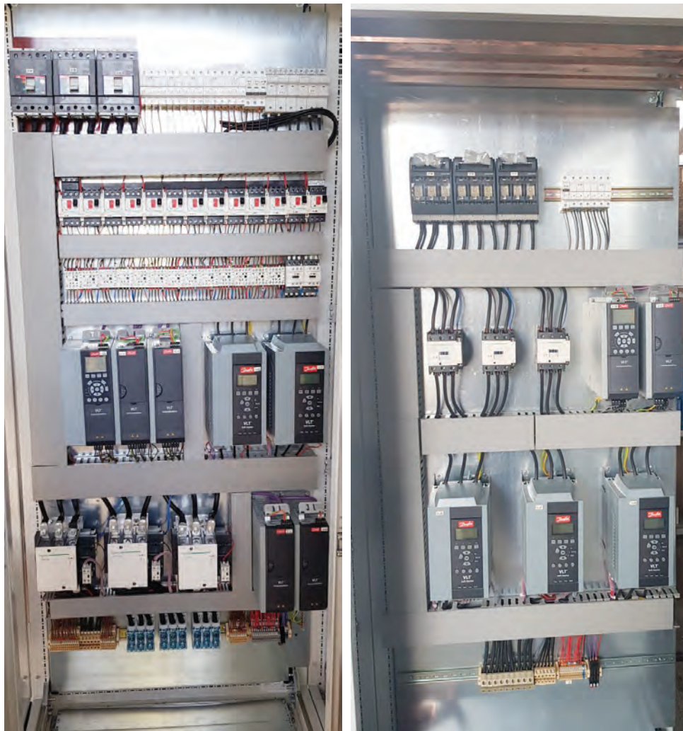
Slika 4. Izgled novih elektro ormara
