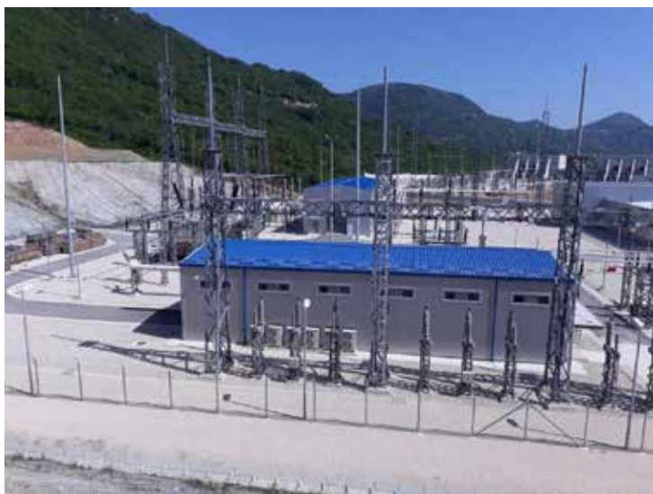
Trafostanica „Lastva“, foto: CGES
