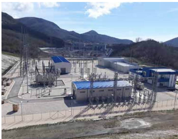
Trafostanica „Lastva“, foto: CGES
