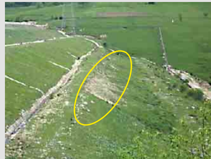
Oštećenje druge stepenice brane Maljevac snimljeno 2007.
