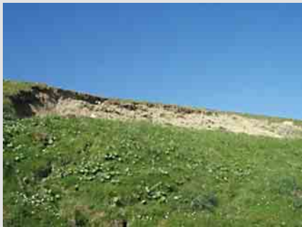
Oštećenja prve i druge stepenice brane Maljevac snimljeno 2007.
