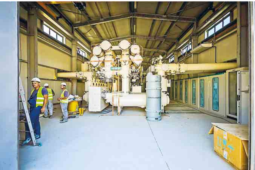
Trafostanica Lastva, foto: foto: cges.me
