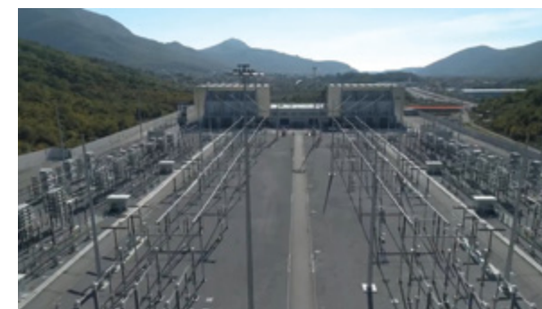
Trafostanica Lastva, sastavni dio elektroenergetskog čvorišta sa konvertorskim postrojenjem HVDC Lastva, foto: terna.it
